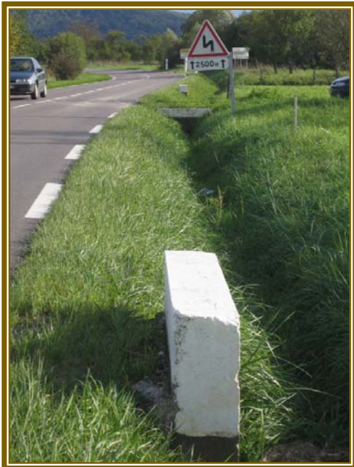
Un fossé dangereux et, dans l'ordre, un parapet, une tête d'aqueduc et un autre parapet dangereux
