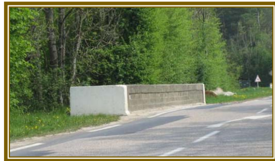
Un parapet dangereux
